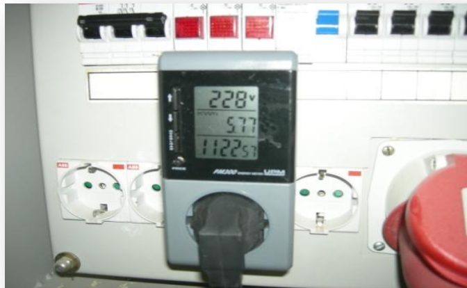
Εικόνα 26: Συσκευή καταγραφής ενεργειακής κατανάλωσης
