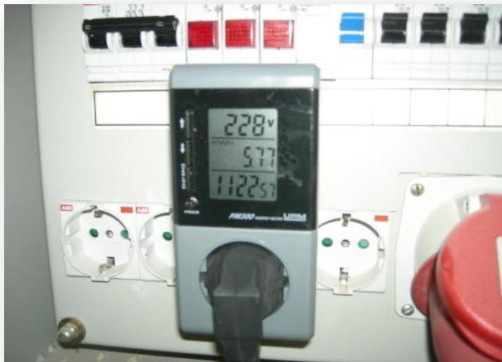
Εικόνα 4: Καταγραφικό ενεργειακής κατανάλωσης
