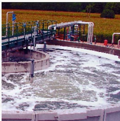
Figura 2. Tratamiento de aguas residuales
